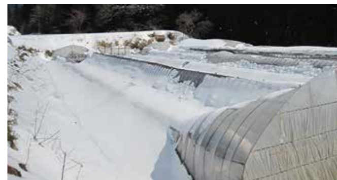
※雪害によるハウスの倒壊
