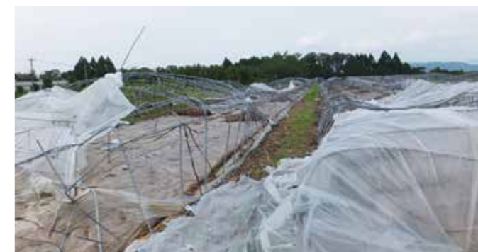
※台風によるハウスの倒壊
